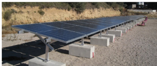
Figura 11. Conjunto de paneles en estructura metálica sobre suelo.
