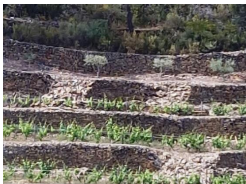
Photo 8. Exemple de dégradation de terrasse, photo J. Rochard.
